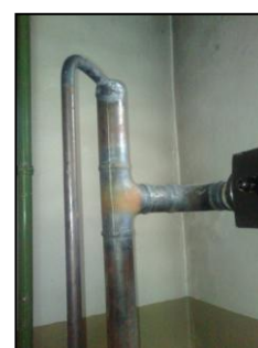
Abb.2: Entlüftungsleitung mit Lufttopf
